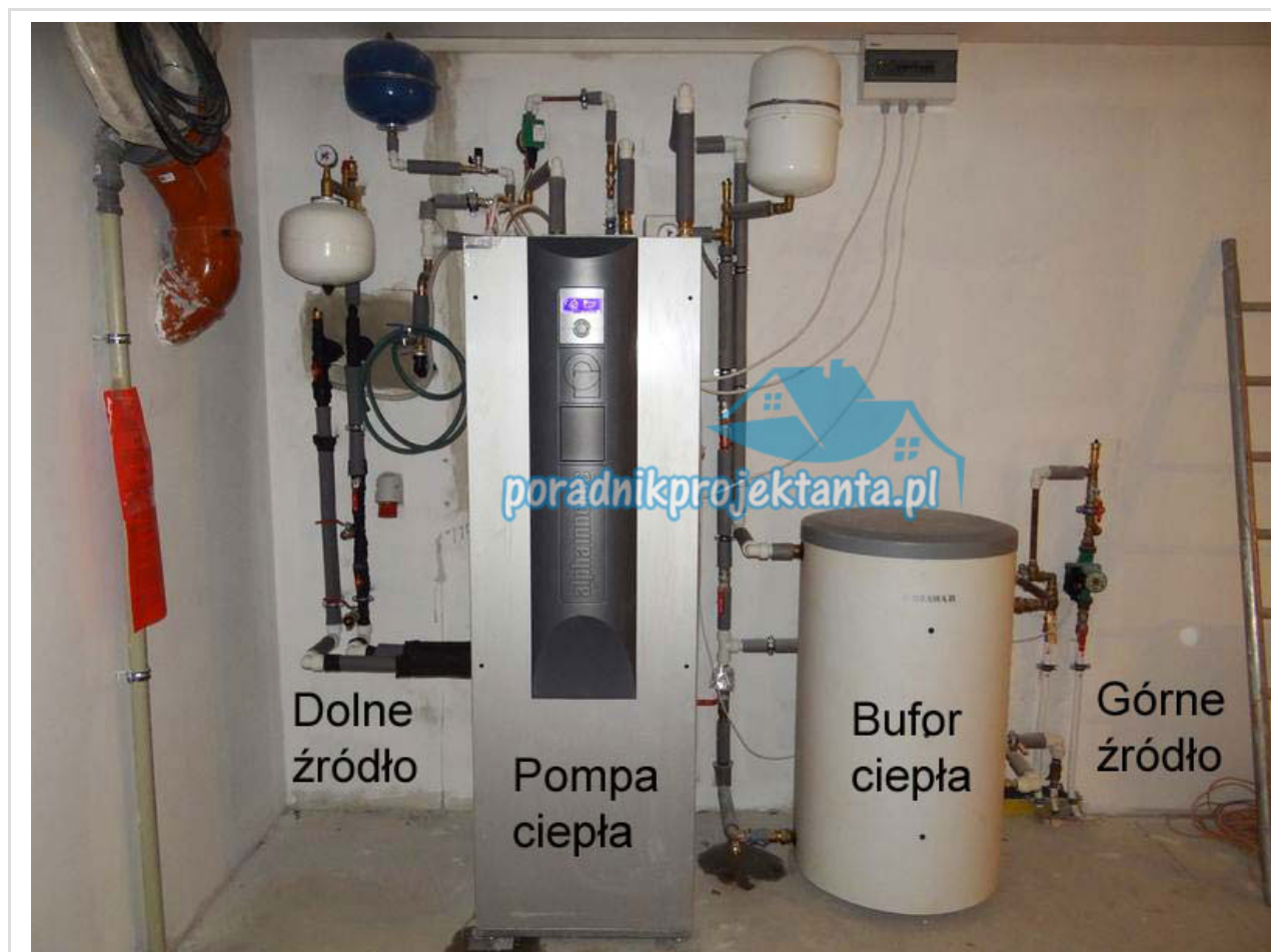
Rynek pomp ciepła 2016 – przykład maszynowni z pompą ciepła
